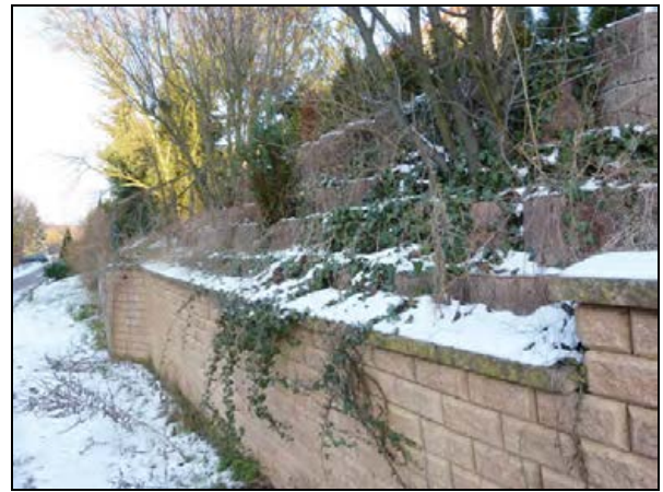
Stützwand aus Bossensteinen im südlichen Teil der Ebereschenstraße, Ansicht von Südost Wegen der zusätzlichen Last der steilen Anschüttung, die durch Hangsteine gehalten wird, neigt sich die Bossensteinwand zur Straße hin.
