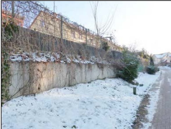
Stützwand aus Winkelsteinen mit aufgesetzten Formsteinen aus Beton und darüber befindlicher Einzäunung an der Ebereschenstraße (nördlicher Teil)
