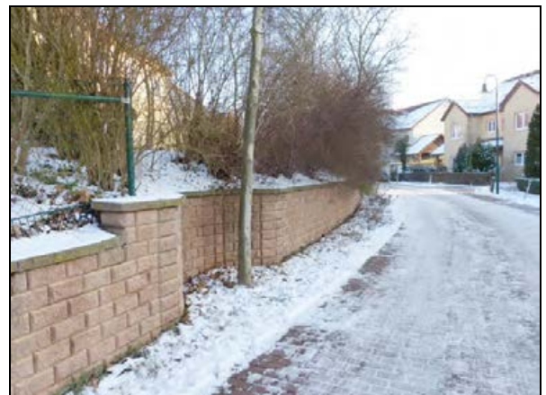
Stützwand aus Bossensteinen im südlichen Teil der Ebereschenstraße, Ansicht von West In diesem Abschnitt ist oberhalb der Bossensteinwand noch die ursprünglich geplante Ausführung mit flacher Böschung vorhanden. Hier steht die Bossensteinwand noch senkrecht.
