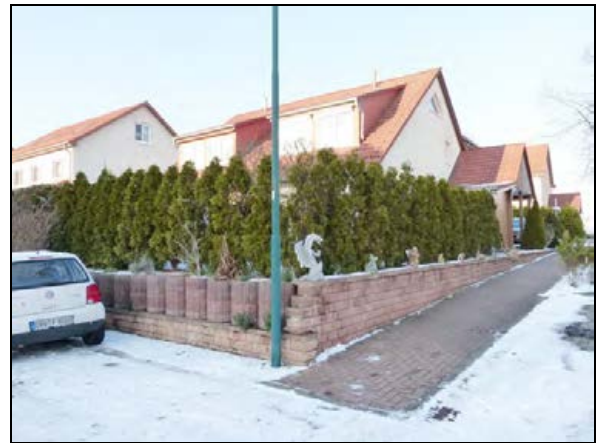
Stützwand aus Bossensteinen im südlichen Teil der Ebereschenstraße Ecke Lindenstraße, Ansicht von Südost Auf der Stützwand wurde entlang der Ebereschenstraße eine Wand aus Hangsteinen als Erhöhung der Stützwand errichtet. Entlang der Lindenstraße wird der Höhenunterschied zwischen der Geländehöhe des Grundstücks und der Straßenhöhe durch eine Stützwand abgefangen.
