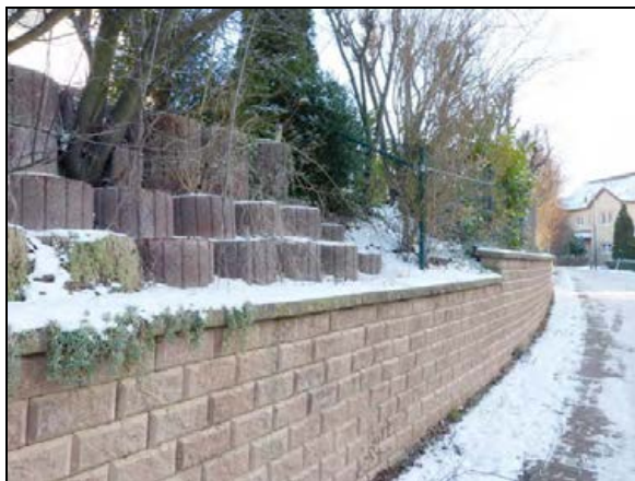
Stützwand aus Bossensteinen im südlichen Teil der Ebereschenstraße, Ansicht von West Wegen der zusätzlichen Last der steilen Anschüttung, die durch Hangsteine gehalten wird, neigt sich die Bossensteinwand zur Straße hin.
