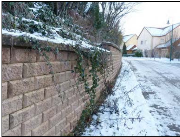
Stützwand aus Bossensteinen im südlichen Teil der Ebereschenstraße, Ansicht von Nordwest Wegen der zusätzlichen Last der steilen Anschüttung, die durch Hangsteine gehalten wird, neigt sich die Bossensteinwand zur Straße hin.
