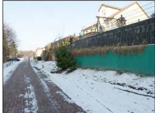
Stützwand aus Winkelsteinen mit aufgesetzten Formsteinen aus Beton und darüber befindlicher Einzäunung an der Ebereschenstraße (nördlicher Teil)
