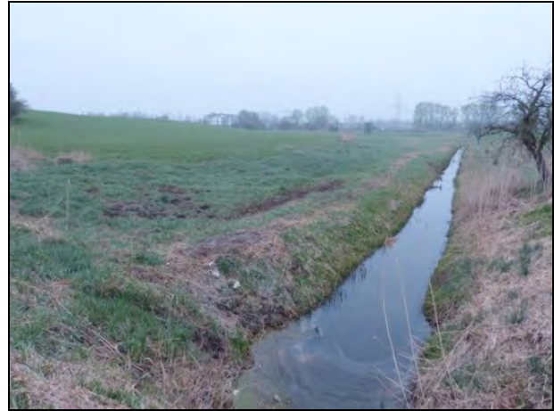
Der Schönwalder Südgraben, begrenzt das Plangebiet im Osten. Er ist ein technisch ausgebauter Entwässerungsgraben mit V-Profil, (Blick von Süd) April 2017
